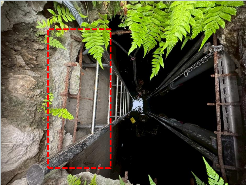
壁體鋼筋腐蝕外露
