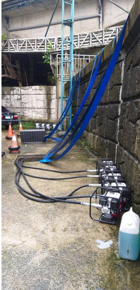
圖二 抽水機佈設
