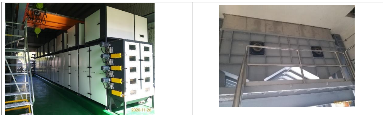
圖五、林口水資污泥乾燥主機及乾燥污泥儲料斗
