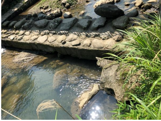
圖 3 護岸基腳、固床工掏空
