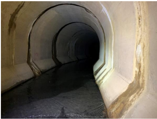
圖 5 分洪設施結構裂縫滲水
