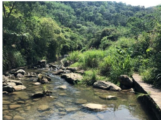
圖 2 護岸雜草、雜木叢生
