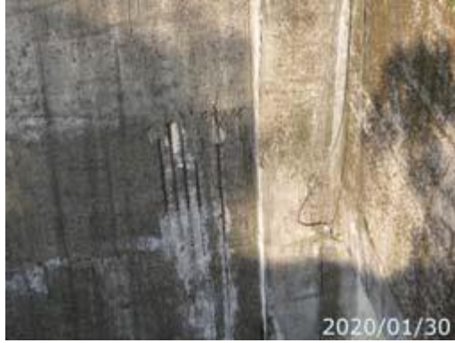
圖 4 水利建造物表面鋼筋裸露(圖 4)
