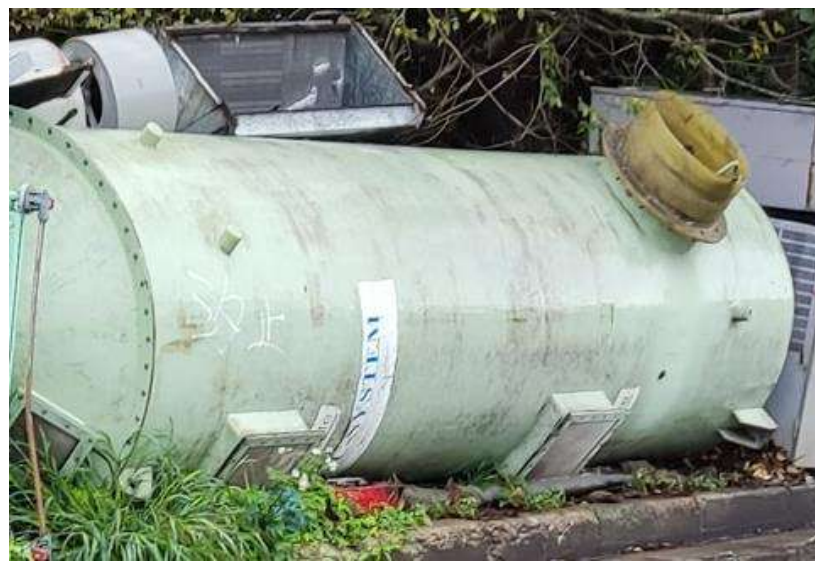
15. 圍籬內左邊-除臭洗滌塔
