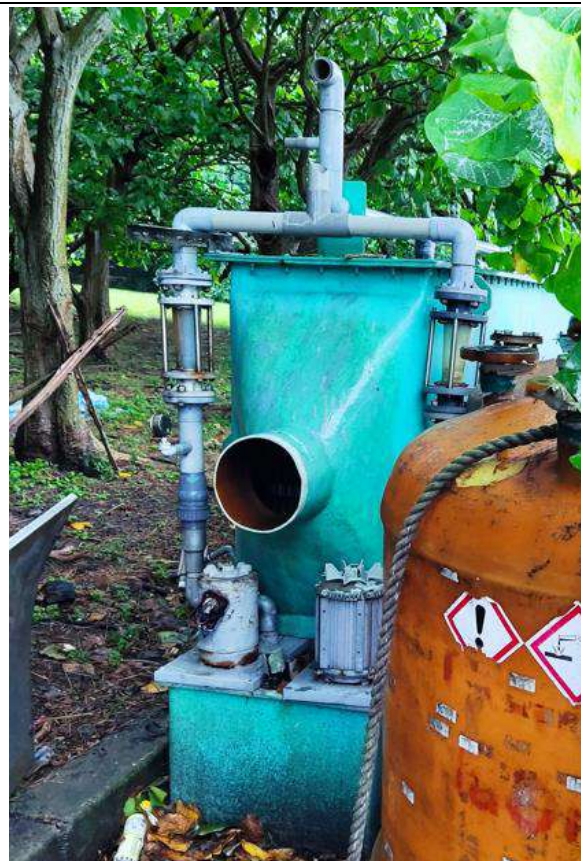
13. 圍籬內左邊儲臭藥桶後-除臭洗滌塔
