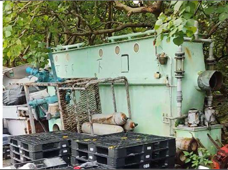
11. 圍籬內左邊草地-風管
