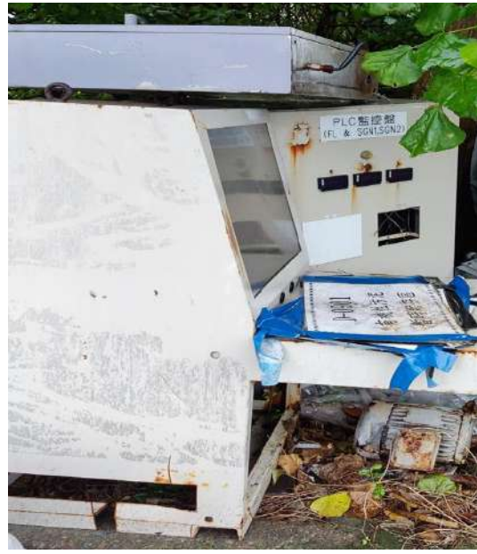
17. 圍籬內左邊-電盤
