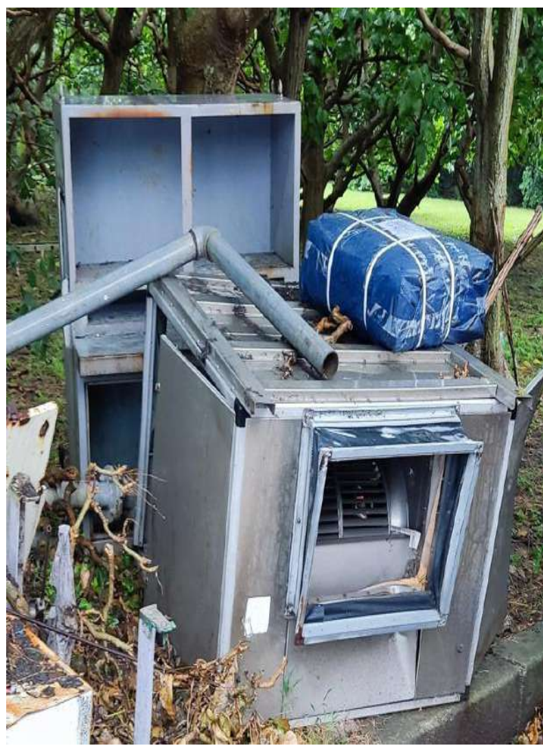
16. 圍籬內左邊-吸排風機
